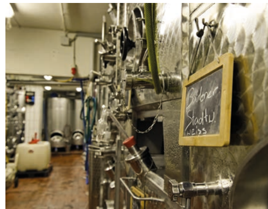
Kelterungsanlage der Spitaltrotte.
